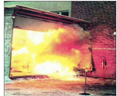
Ljusbåge i ställverk
